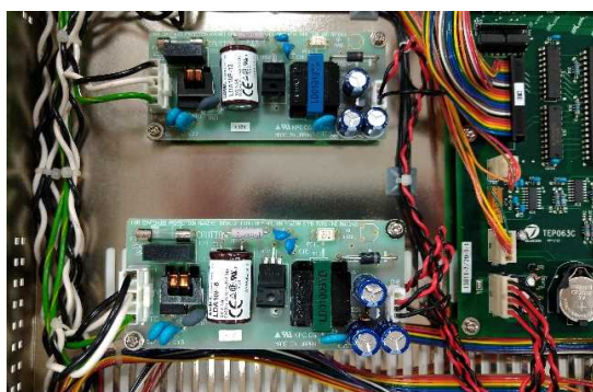
[写真13]電源交換後参考図
